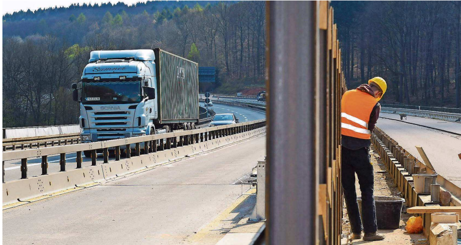
Eine Vollsperrung der Brücke soll vermieden werden. Auf einer Spur rollt der Verkehr über den neueren Brücken-Teil.
